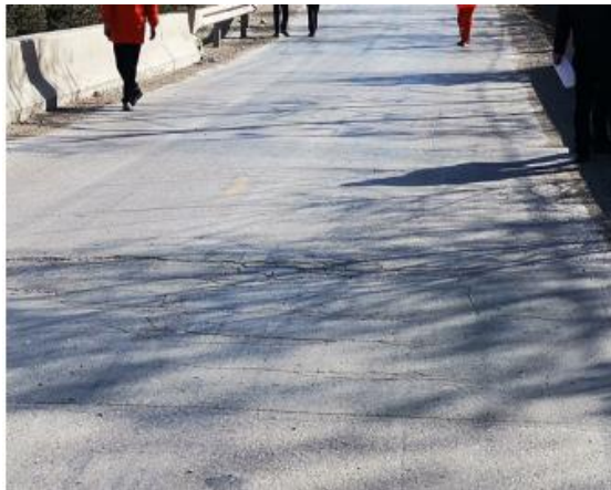
原有桥梁桥面破损现状
